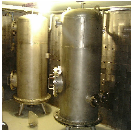
Figura 2. Tanque de Resinas e Filtro de Carvão de um dos Circuitos do Sistema de Retratamento da Água do Reator IEA-R1 Atualmente em Operação.
