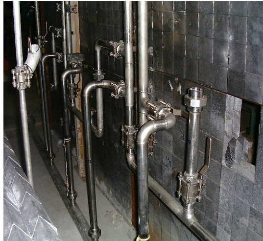
Figura 3. Exemplo de Algumas das Válvulas do Atual Sistema de Retratamento de Água do Reator IEA-R1 Instaladas Fora da Blindagem que Circunda os Tanques de Resinas e Filtros de Carvão.
