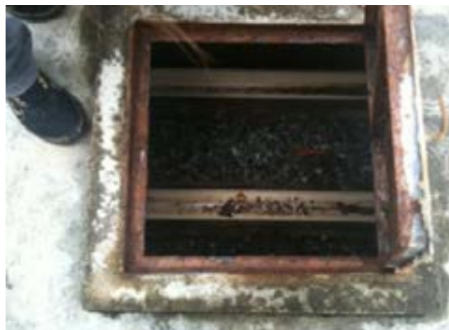
Figura 19. Não funcionamento das caixas separadoras de água e óleo
