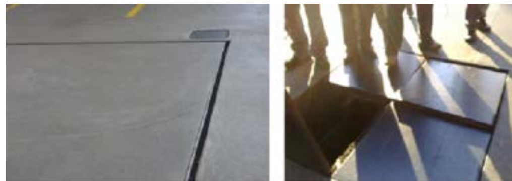
Figura 12 e 13. Canaletas e conjunto de separador de água de óleo
