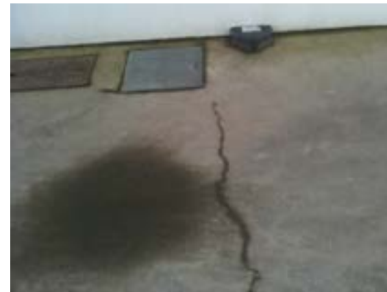
Figura 16. Fissura no pavimento
