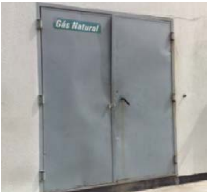
Figura 22. Porta danificada da sala de condicionamento de gás natural.
