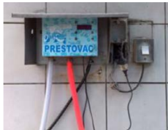
Figura 21. Fiação exposta do quadro de comando elétrico do equipamento de lavação.
