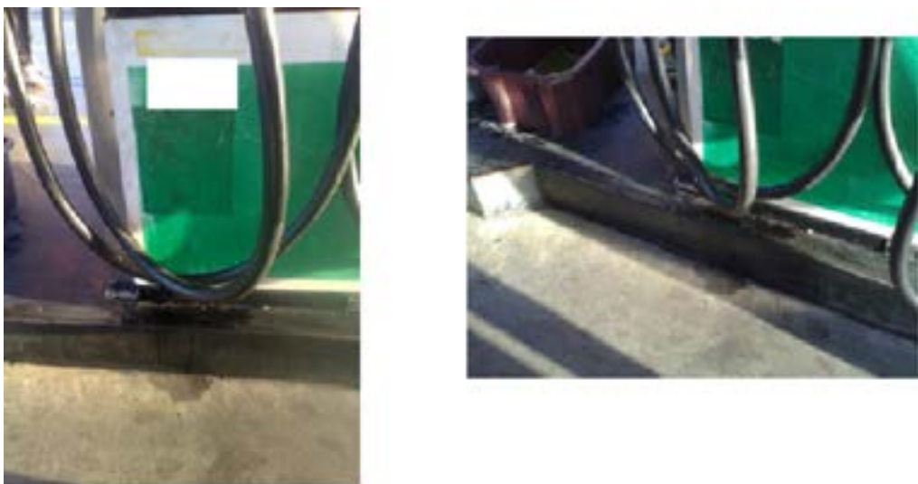
Figura 14 e 15. Vazamento de óleo combustível do bico da mangueira de abastecimento.
