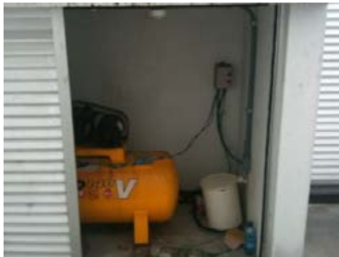
Figura 18. Ausência da porta do compressor de ar
